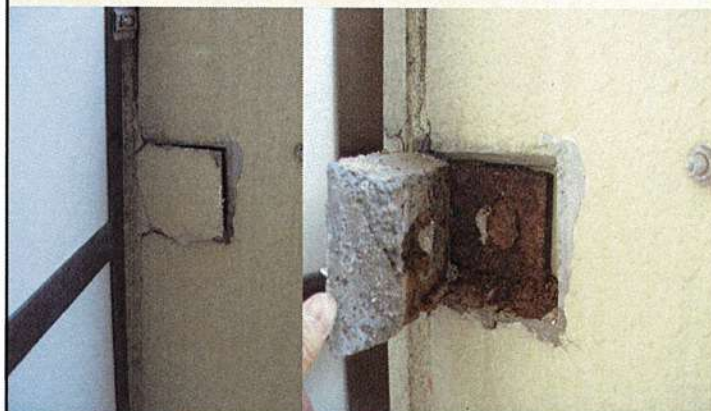
・モルタル欠損
