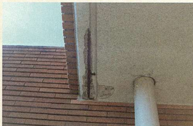
・鉄筋露出現象
