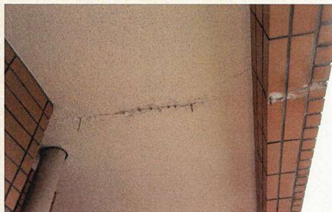
・防水関係の劣化現象
